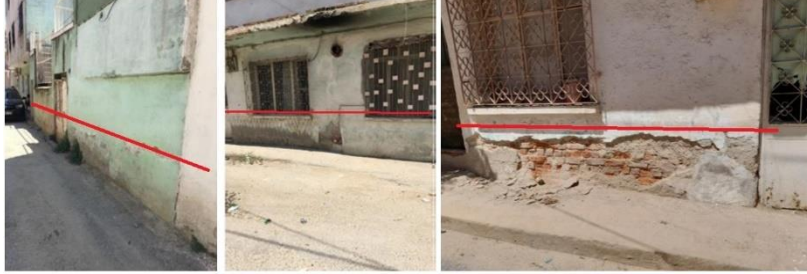
Şekil 7 Selin yapılarda bıraktığı izler (Arazi çalışmaları sırasında yazarlar tarafından çekilmiştir)
